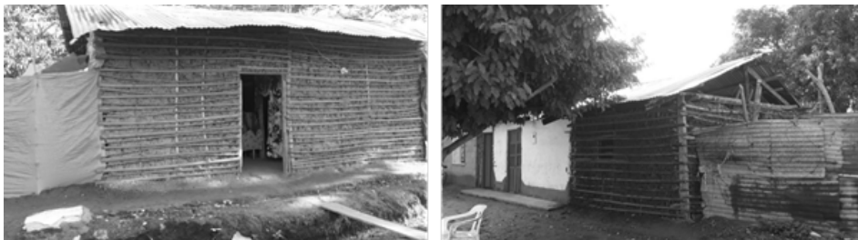
Figura 2. Análisis de patologías, fracturación en las capas de recubrimiento.
